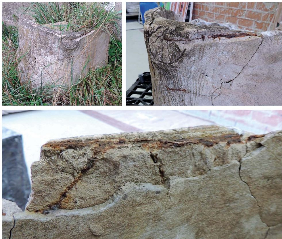
Figura 2. Macetero N° 2 previo a su intervención y detalle de las armaduras. 2021
